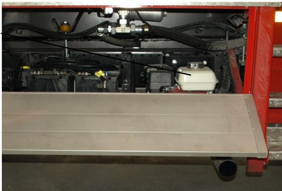
Фотография номер 4. Аварийный насос, поз. 15 на гидравлической схеме.
